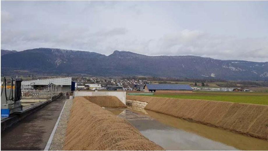
Zulaufkanal und Beginn Retention
